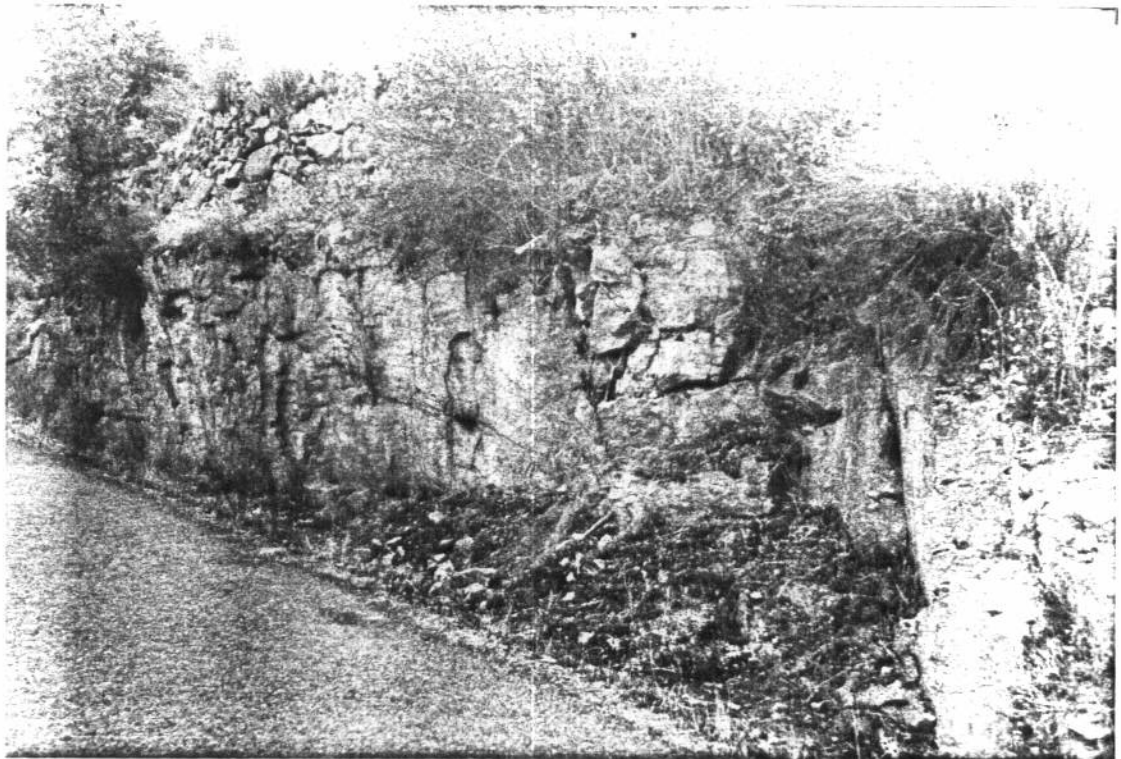
Dique de episienita muy fracturado.
